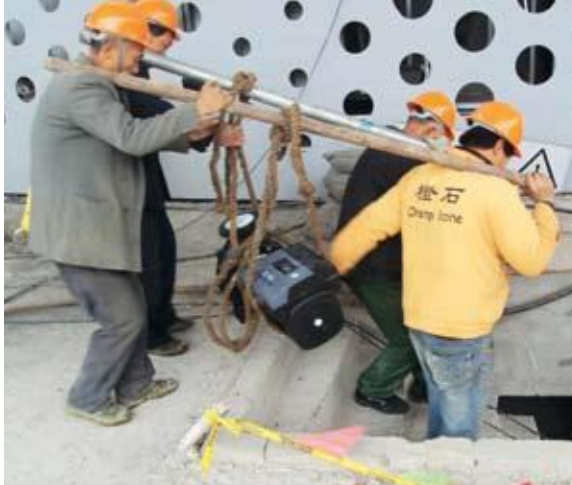
Det er ganske enkelt at få de tunge pumper bragt i kælderens
